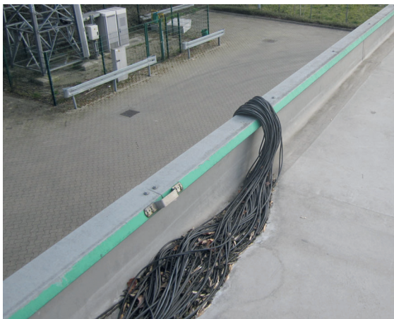
Abb. 4.5-6: Trennungsabstand nicht eingehalten, Beispielbild 2, Quelle: VGH Versicherungen
