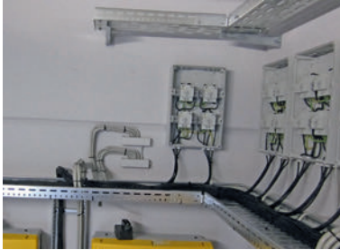
Abb. 4.5-3: Ableitung parallel zu geschützten Stromkreisen geführt, Quelle: VGH Versicherungen
