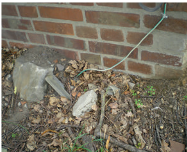
Abb. 4.5-4: Behelfsmäßige Erdungsanlagen, Quelle: VGH Versicherungen
