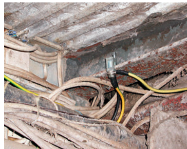
Abb. 4.5-5: Behelfsmäßige Erdungsanlagen, Quelle: VGH Versicherungen
