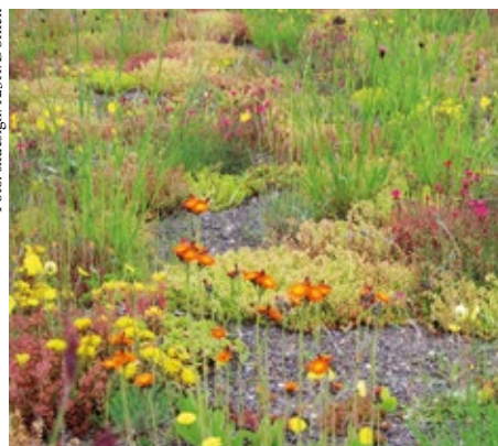
Die Begrünung von Flachdächern hat viele bauphysikalische und ökologische Vorzüge. Eine extensive Begrünung besteht meist aus Sedum-Arten, Moosen, Kräutern und trockenheitsverträglichen Gräsern mit einer Substrathöhe von etwa 6–15 cm.
