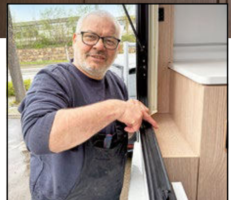
Rudi Stahl zur Karosserie: Wie üblich ordentlich verarbeitet, zeigt dieser Adria doch eine Schwäche. Steht er nicht ganz gerade, tropft Regenwasser auf die Möbel. ▶
